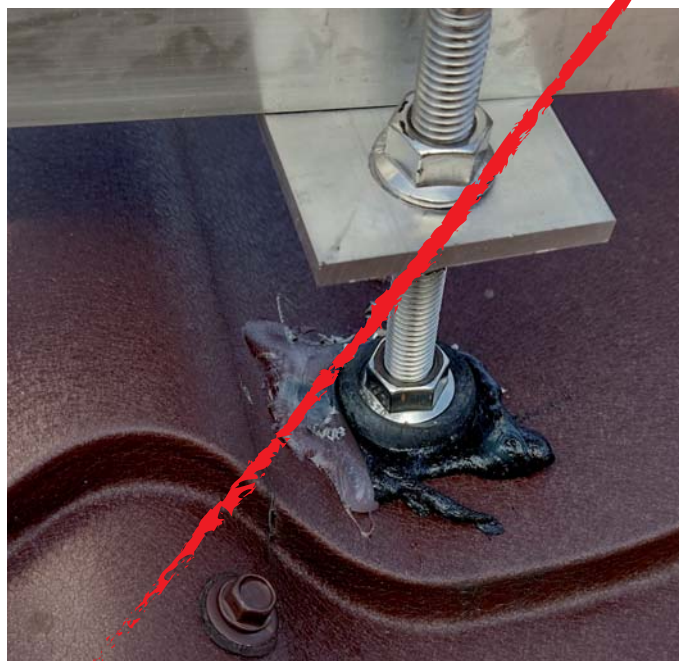
Takto NE! Kotvení FVE skrze krytinu do podkladní konstrukce má mnoho závažných rizik
